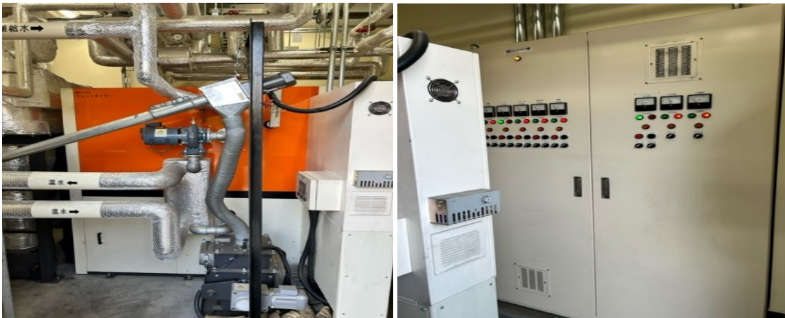
ボイラー室内
