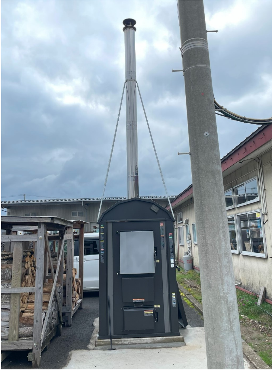
ボイラー外観
