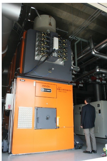
チップボイラー
