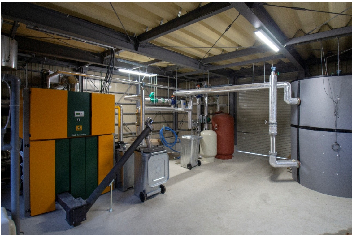
チップボイラー
