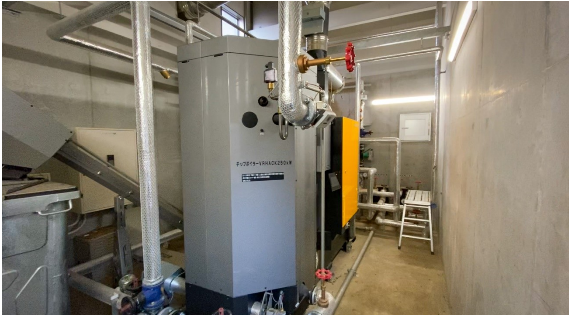
チップボイラー
