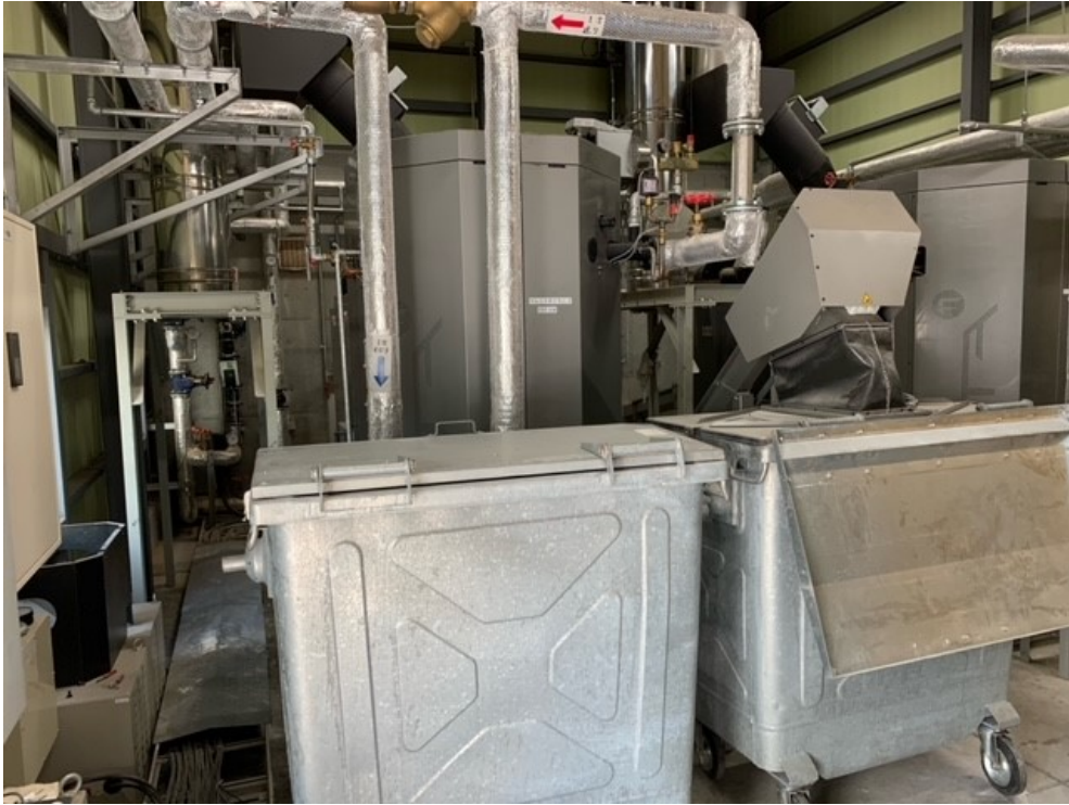
ペレットボイラー
