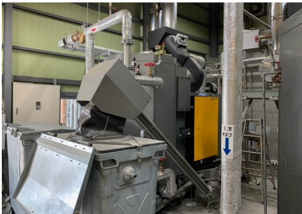
ペレットボイラー
