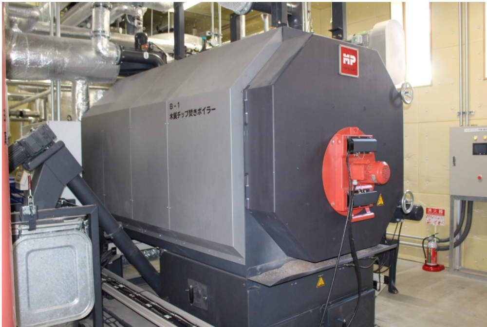
チップボイラー
