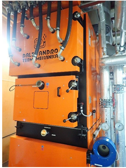
チップボイラー
