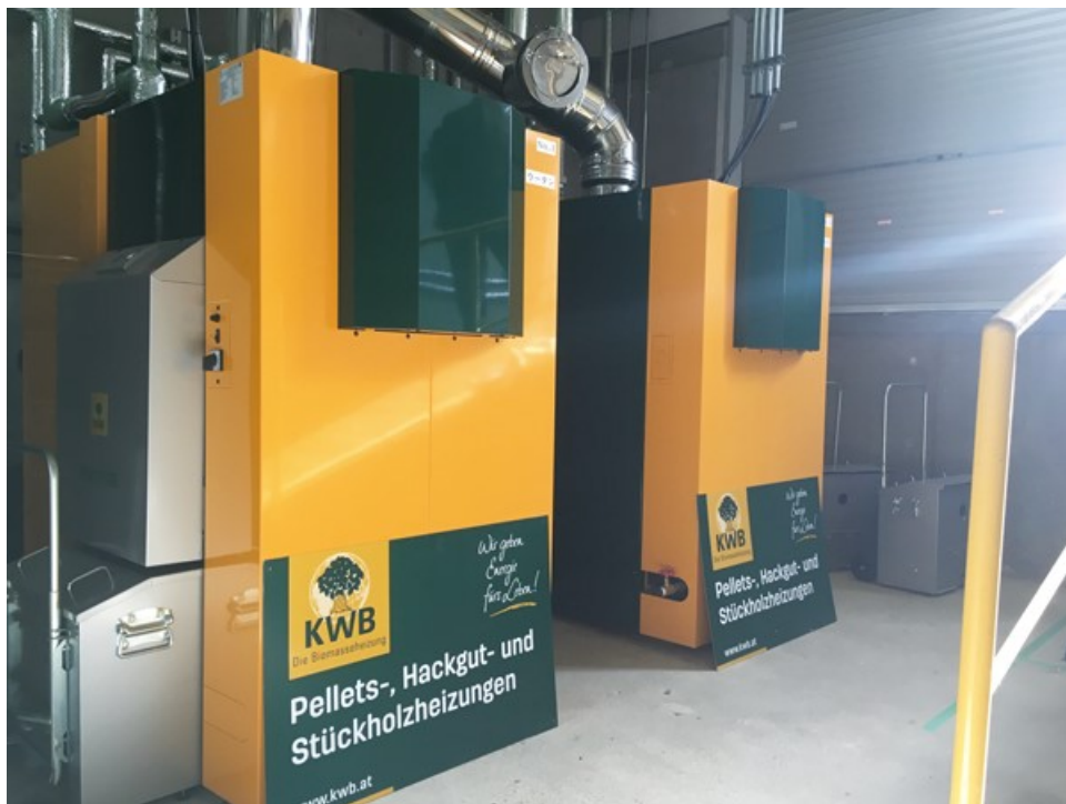
（出典：もりもりバイオマス株式会社ホームページ） チップボイラー
