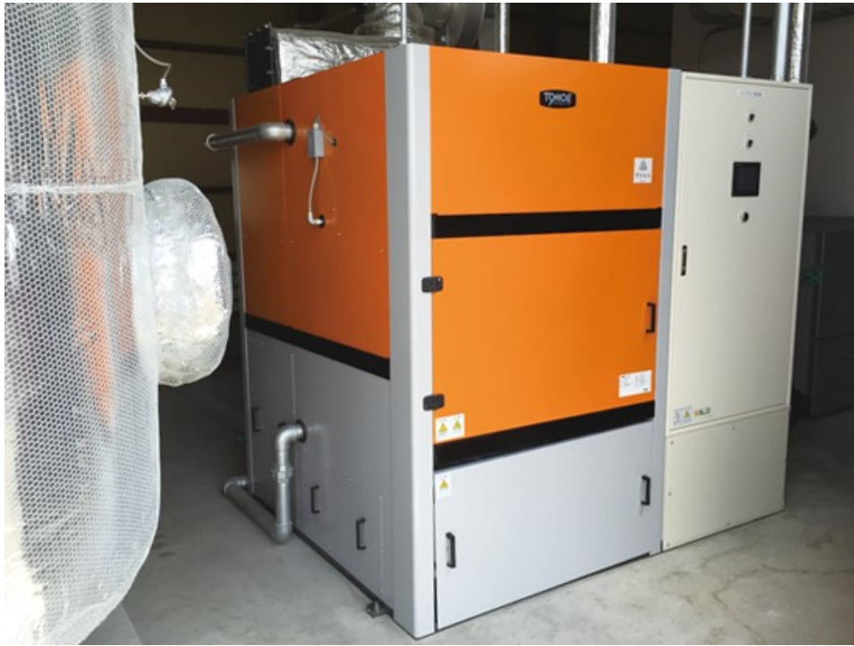
(出典：もりもりバイオマス株式会社ホームページ) チップボイラー (1号機)
